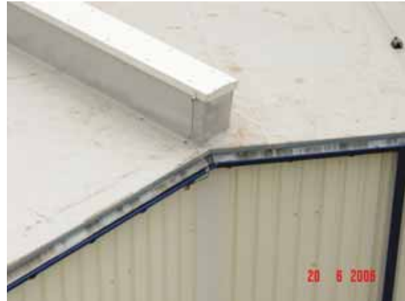
Abb. 1: Unzureichender Anschluss einer Brandwand im Bereich Dach und Außenwand
