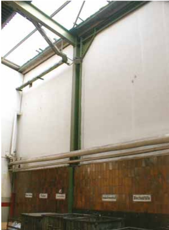
Abb. 3: Mängelbeispiel bei einer Brandwand
