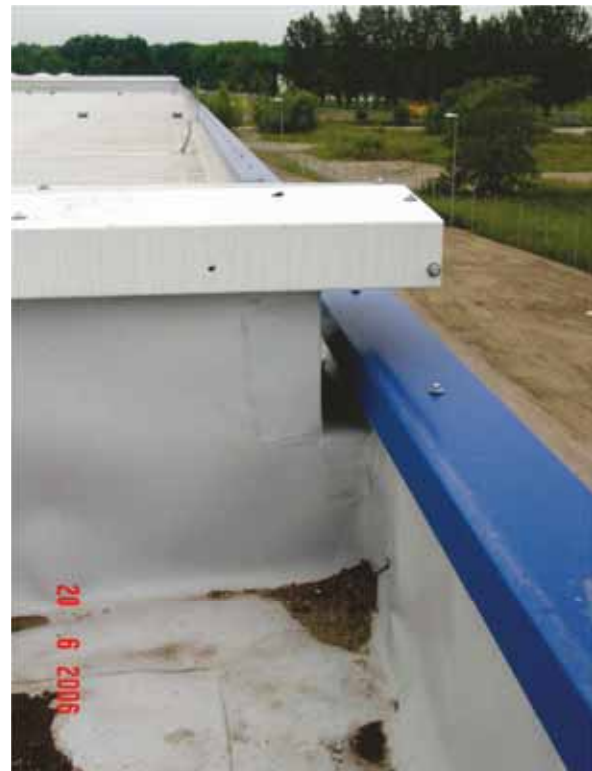
Abb. 2: Unzureichender Anschluss einer Brandwand an die Außenwand (Attika)
