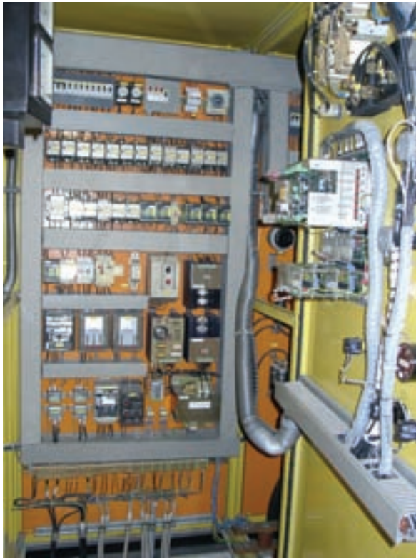
Bild 05: Steuerung eines Notstromaggregats
