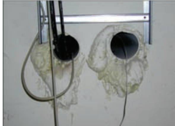
Bild 04: Nicht geschottete Leitungsdurchführung, zudem unfachmännisch mit Montageschaum eingesetzt
