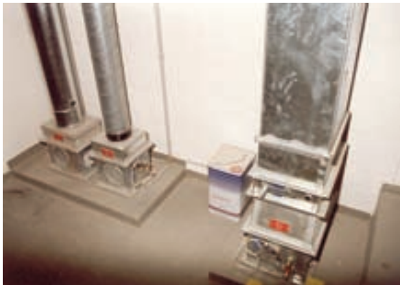
Bild 08: Brandschutzklappen in Lüftungskanälen
