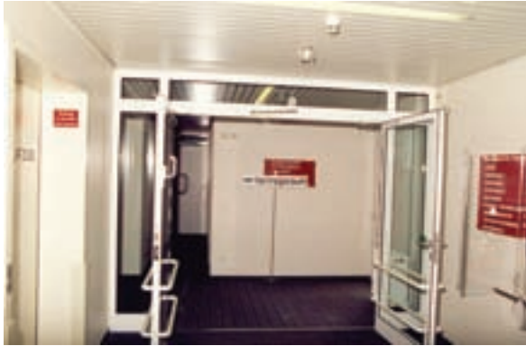
Bild 03: Rauchschutztür Rauchmelder gesteuert
