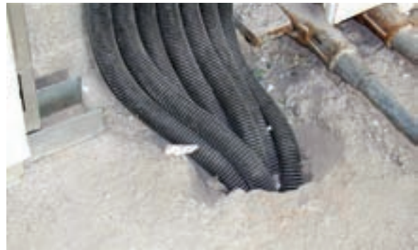
Bild 14: Unzureichender Brandschutz durch die Verlegung von brennbaren Leerrohren durch eine Decke mit Anforderungen an die Feuerwiderstandsdauer
