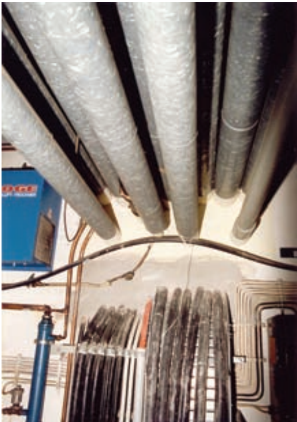
Bild 13: Schottung von elektrischen Kabeln und Leitungen
