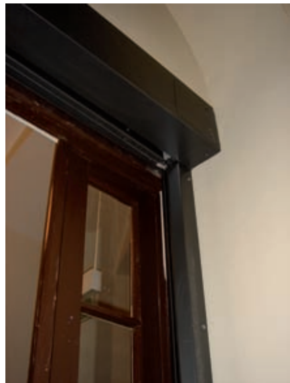
Abbildung 12: Brandschutzrollo vor Tür (ingerollt) (Quelle: A.-K. Zülch)
