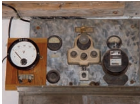
Abbildung 8: historische Elektroinstallation (Quelle: J. Zenger)
