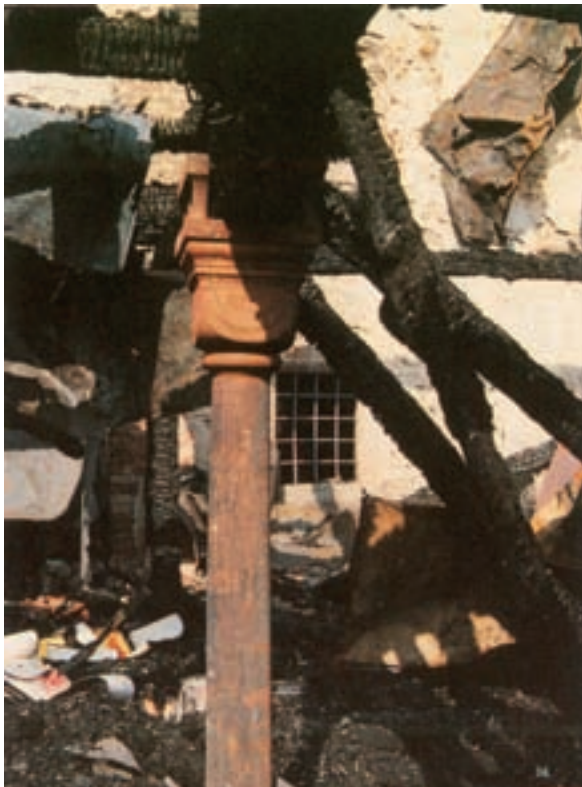
Abbildung 6: ungeschützte Gusseisenstütze nach Brandbelastung (Quelle: Versicherungskammer Bayern)
