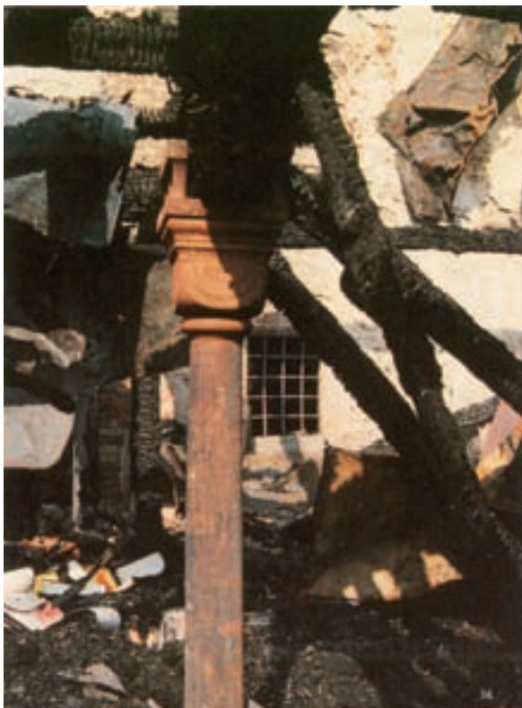
Abbildung 6: ungeschützte Gusseisenstütze nach Brandbelastung (Quelle: Versicherungskammer Bayern)
