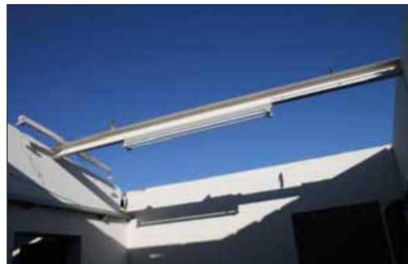
Abb. 11: Eine beschädigte Dachöffnung (Quelle: HGI)
