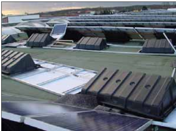
Abb. 3: Photovoltaik-Module, die beim Sturm Kyrill aufgrund der unzureichenden Befestigung beschädigt wurden (Quelle: Mannheimer Versicherung)
