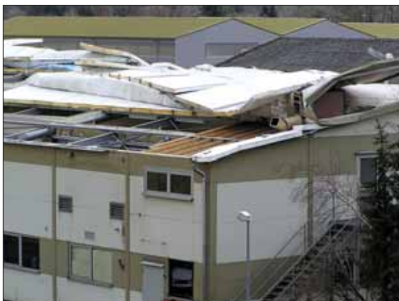
Abb. 9: Das abgehobene Dach (Quelle: HGI)
