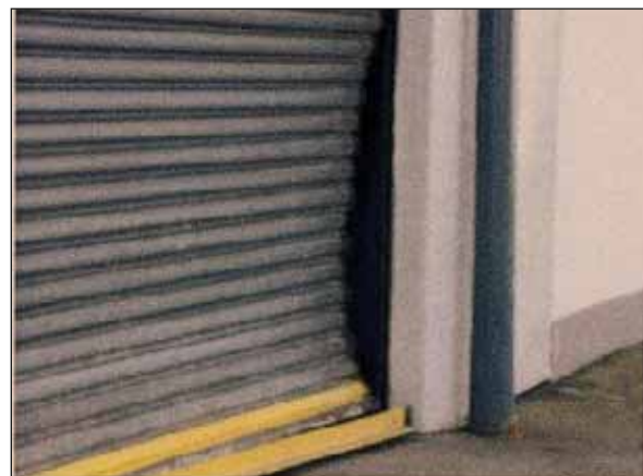
Abb. 20: Detailansicht eines beschädigten Tors (Quelle: HGI)
