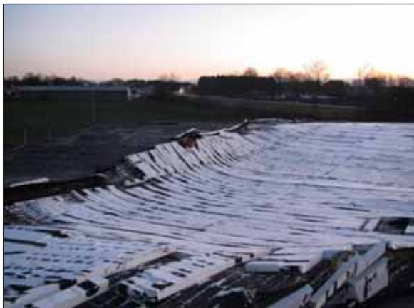
Abb. 12: Abgehobene Dachschichten der Halle 3 (Quelle: HGI)
