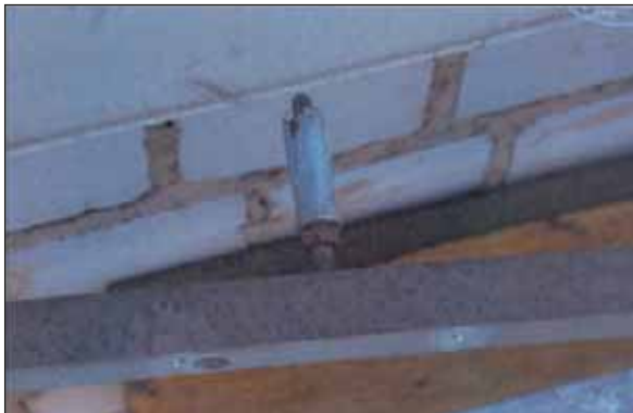
Abb. 18: Beispiel eines herausgerissenen Dübels (Quelle HGI)
