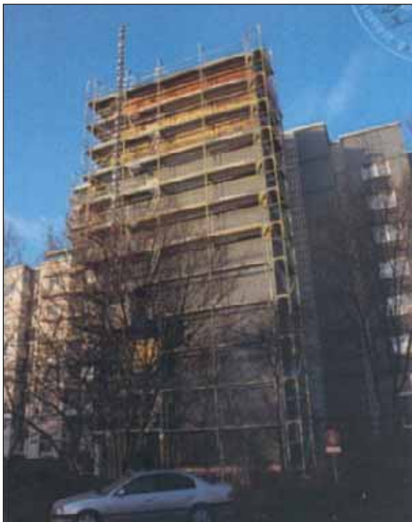
Abb. 15: Ansicht der beschädigten Fassade (Quelle: HGI)
