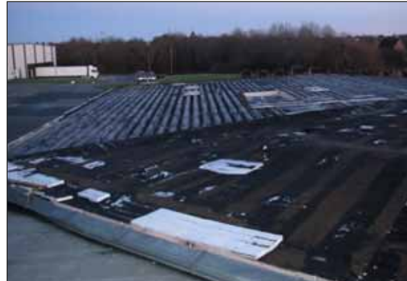
Abb. 13: Abgehobene Dachschichten der Halle 1 mit beschädigten Lichtkuppeln (Quelle: HGI)
