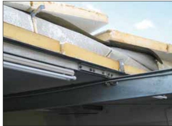
Abb. 10: Aufbau der abgehobenen Dachhaut und -konstruktion (Quelle: HGI)
