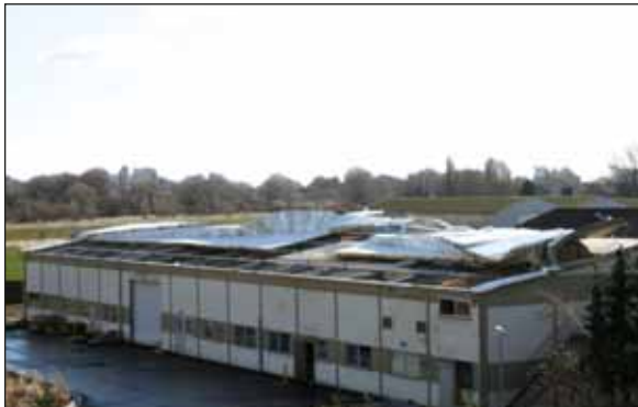
Abb. 8: Lagerhalle mit dem beschädigten Dach (Quelle: HGI)
