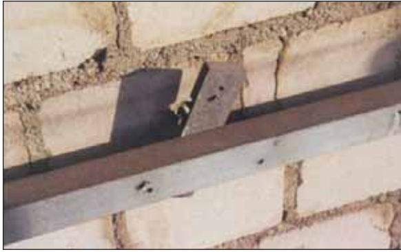
Abb. 17: Beispiel herausgerissener Befestigung (Quelle: HGI)
