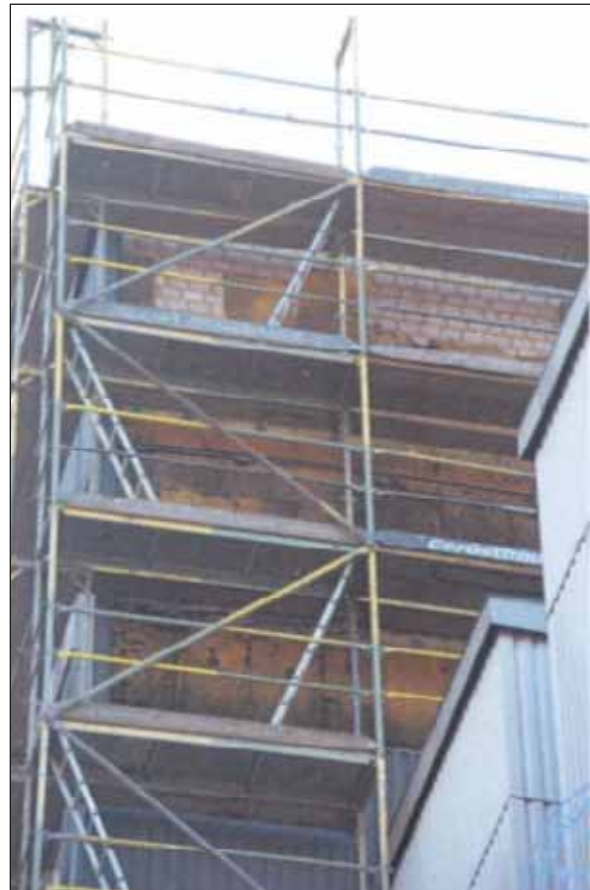
Abb. 16: Die beschädigte Fassadenfläche (Quelle: HGI)
