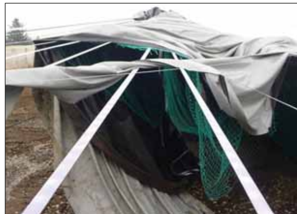
Abb. 25: Detailansicht des zerstörten Membrandachs (Quelle: Gothaer Risk-Management GmbH)
