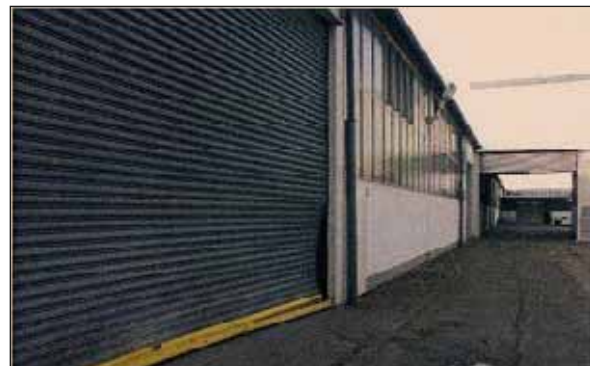
Abb. 19: Ein beschädigtes Tor (Quelle: HGI)
