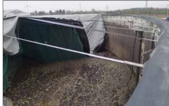
Abb. 24: Ein zerstörtes Membrandach (Quelle: Gothaer Risk-Management GmbH)
