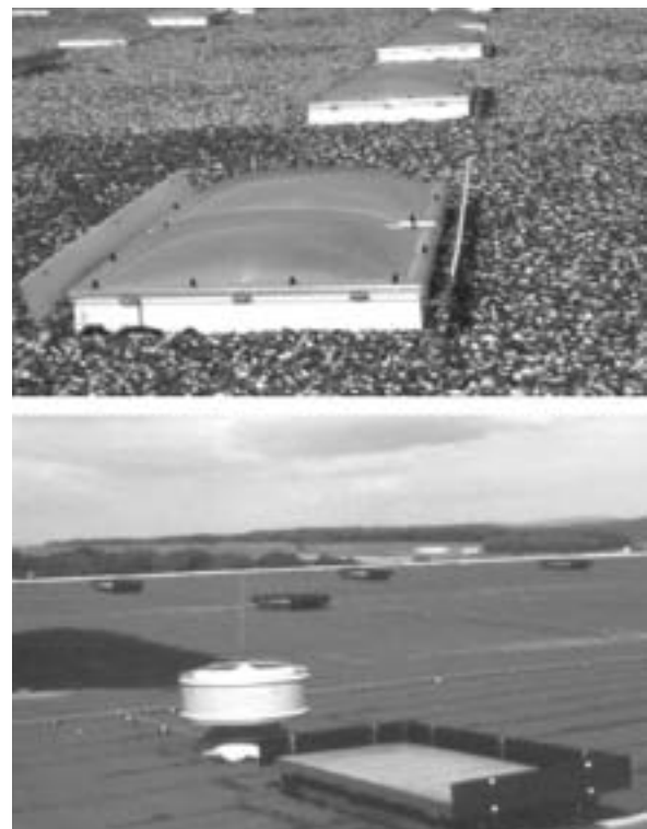
Abbildung 5: Dachaufbauten: Rauch- und Wärmeabzugsanlagen
