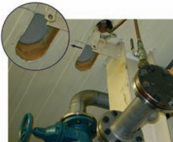
Bild 6.05: Beispiel einer ungeschützten Öffnung im Sandwichelement mit offen liegendem Dämmstoff
